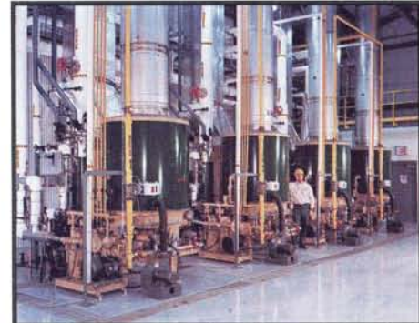
Instalación Múltiple de Generadores de Vapor Clayton en Importante Hospital Central del Sector Salud. Cuatro Generadores de Vapor.
